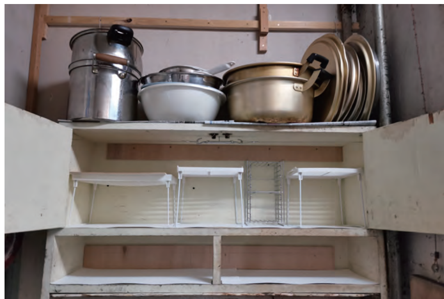
上段：腐食した排水管の交換、床の張替え 下段：棚の増設、倒壊した食器棚の修理
